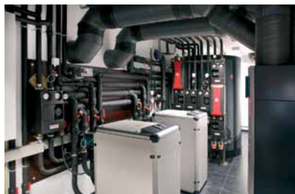
De duurzame energietechniek wordt aangestuurd vanuit deze grote technische ruimte en is ontwikkeld en geïnstalleerd door JTS Energietechniek.
